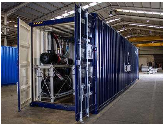
Tedagua lidera el refuerzo en el abastecimiento hídrico en Ibiza con una nueva planta desaladora contenerizada
